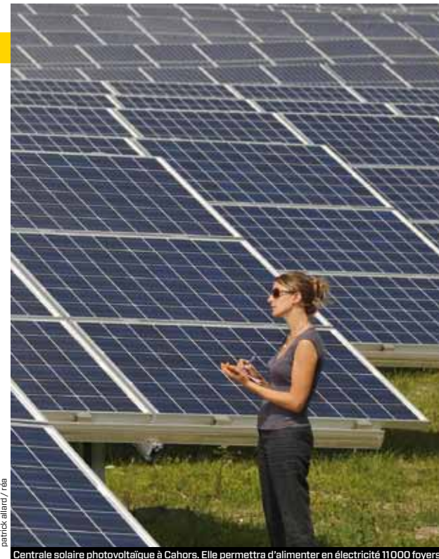
Centrale solaire photovoltaïque à Cahors. Elle permettra d'alimenter en électricité 11 000 foyers.
